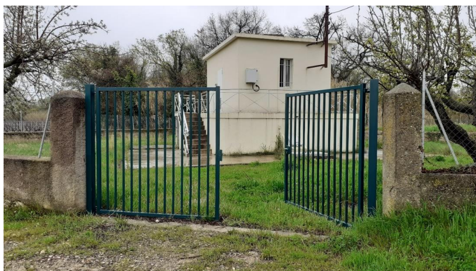
Captage : clôture et local technique [photo CE
