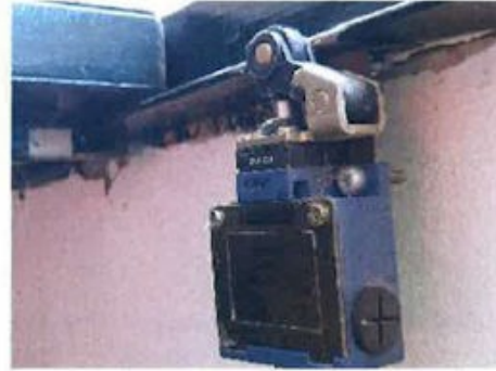
Capteur anti-intrusion local technique
