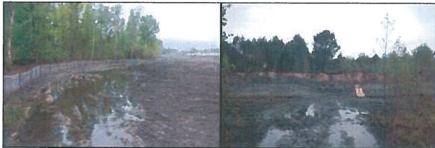
Ornières et flaques favorables aux amphibiens créées par des engins de chantier (Photographies : Naturalis)
